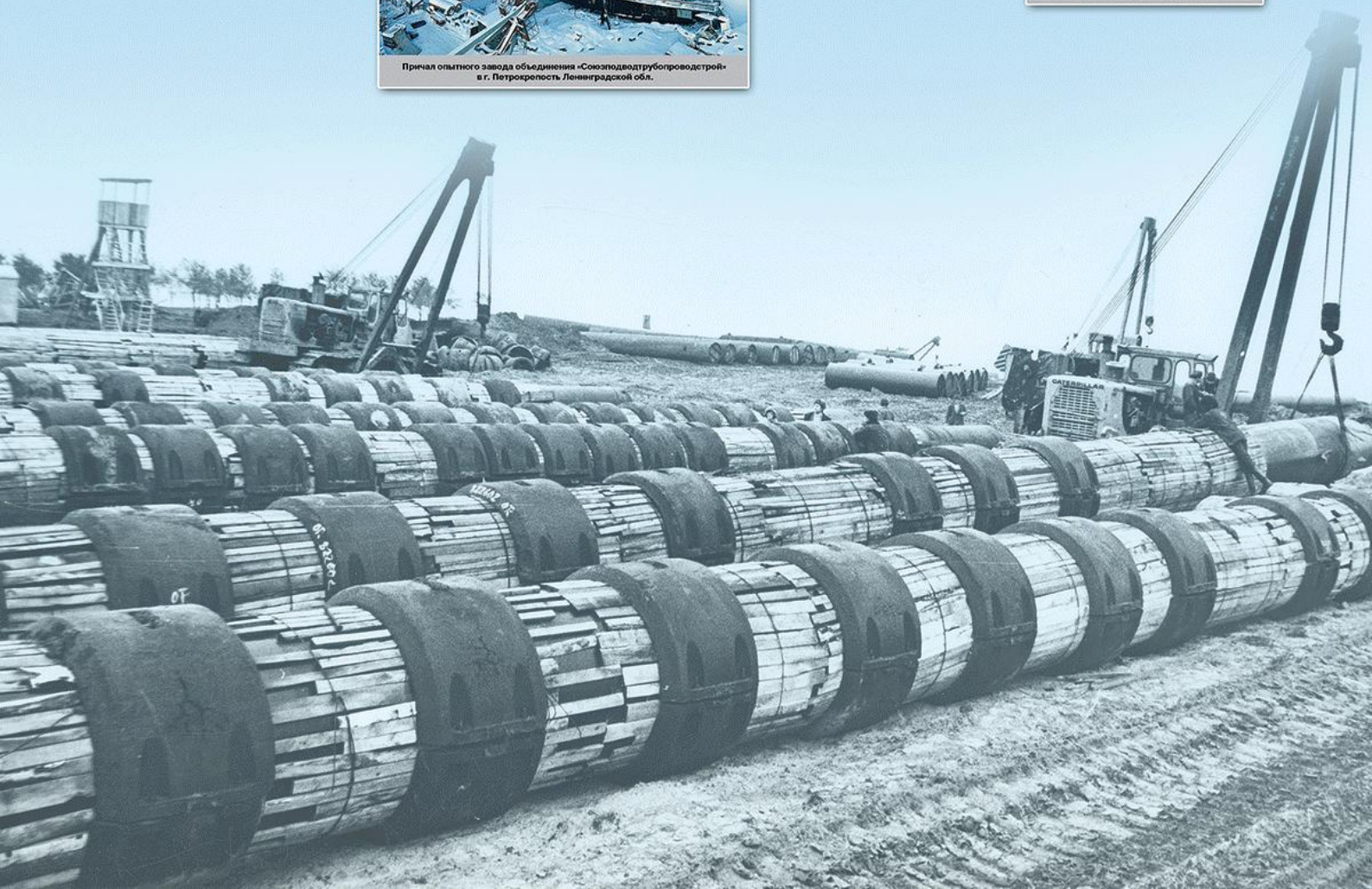
На строительстве подводного перехода газопровода Холмогоры – Клин через р. Волгу Водолазы СУПТР-4 М.А. Новиков и Н.В. Абрамов готовят к спуску под воду своего коллегу Ю.М. Давылова
